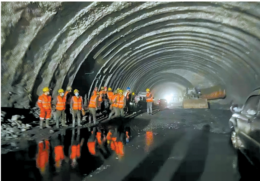
绵茂公路最后一座隧道——篮家岩隧道顺利贯通。图据川观新闻
