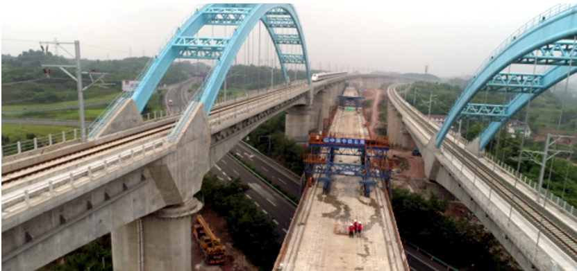
成自高铁成自泸高速立交双线特大桥梁合龙。成兰铁路公司供图
