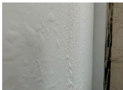
整改前房屋负一层漏水。
