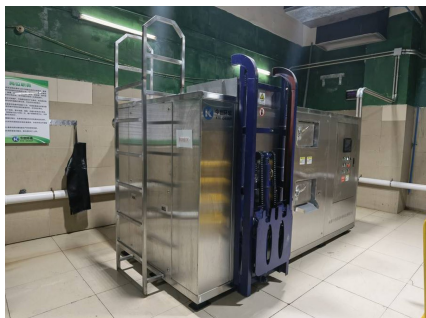
大悦城负一楼的厨余垃圾处理设备。
