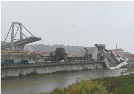
垮塌的公路桥。
