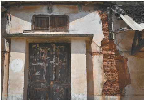
粮仓年久失修，有的墙体已经脱落，有的屋顶瓦片还会漏雨。透过脱落的表皮你能看到墙体由黄筋泥、碎石、竹条、稻草和土石灰夯成。
